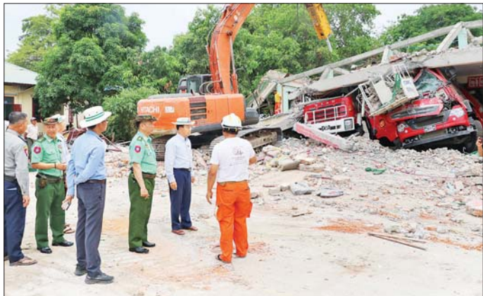
စစ်ကိုင်းမြို့ပေါ်ရှိ ငလျင်ဘေးဒဏ်ခံစားခဲ့ရပြီး ပြိုကျပျက်စီးခဲ့သည့် အဆောက်အအုံများကို တာဝန်ရှိသူများက ကြည့်ရှုစစ်ဆေးစဉ်။
