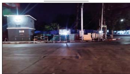
၂၀၂၄ ခုနှစ် မေ ၁၂ ရက်တွင် အင်းစိန်မြို့နယ် ပေါက်တောင်မီးပွိုင့်ရှိ ဆက်သွယ်ရေး Box အား မိုင်းထောင်ဖောက်ခွဲခဲ့သည့် မှတ်တမ်းဓာတ်ပုံ။
