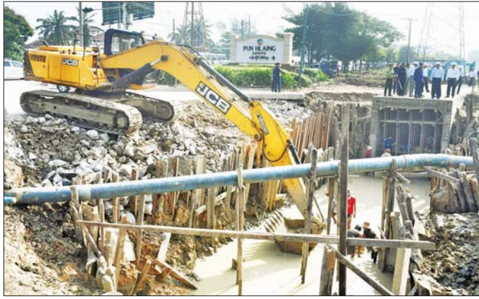
ရန်ကုန် - ပုသိမ်လမ်းဘေး၊ ညောင်ရွာ - ဒိုင်စုအဝင်လမ်းတွင် Box Culvert တည်ဆောက်နေမှုကို ကြည့်ရှုစစ်ဆေးစဉ်။
