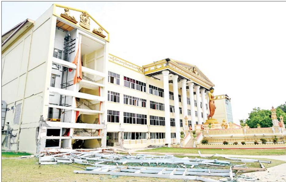
သီတဂူသံဃာသင်္ဃီပါတာကျောင်းဆောင်တော်ကြီး ငလျင်ဘေးဒဏ်ကြောင့် ထိခိုက်ပျက်စီးခဲ့မှုကို တွေ့ရစဉ်။
