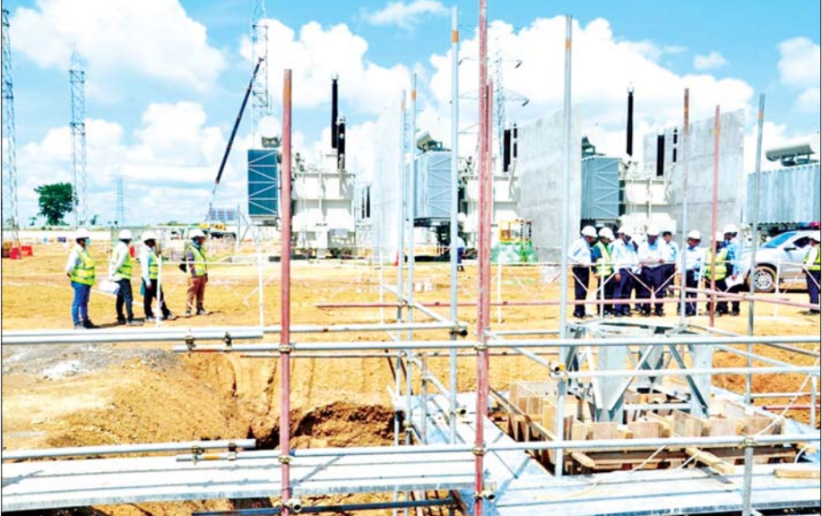
ပထမဆုံးအကောင်အထည်ဖော်ဆောင်ရွက်နေသည့် ၅၀၀ ကေဗီ (ကံကောင်း)ဓာတ်အားခွဲစိတ်မံကိန်း ကို တွေ့ရစဉ်။
