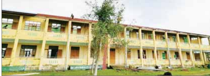
အထက - ကူတောင် ပျက်စီးမှု မိုခါဆိုင်ကလုန်းမုန်တိုင်းကြောင့် ပျက်စီးသွားသည့် အထက - ကူတောင်၊ အဆောင်(၇) (၁၄၄' x ၃၀') RCC နှစ်ထပ်ကျောင်းဆောင် ပျက်စီးမှုကို တွေ့ရစဉ်။
