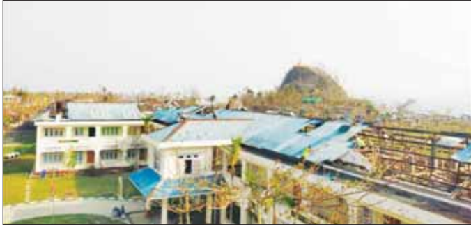
အထက - ရသေ့တောင် ပျက်စီးမှု ရသေ့တောင်မြို့နယ်၌ အလွန်အလွန်အားကောင်းသော မိုခါဆိုင်ကလုန်းမုန်တိုင်းကြောင့် ပျက်စီးသွားသည့် အထက-ရသေ့တောင် ကျောင်းဆောင်သစ် (၃၂၂' x ၃၀') RCC နှစ်ထပ်ကျောင်းဆောင် ပျက်စီးမှုကို တွေ့ရစဉ်။
