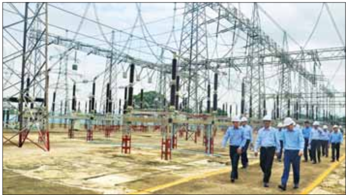
စဉ်ဆက်မပြတ် ထိန်းသိမ်းစစ်ဆေးဆောင်ရွက်ရေး Yard အတွင်း ဓာတ်အားဖြန့်ဖြူးပေးထားမှုများကို တို့ကိုဖွဲ့ကြားပြီး ဓာတ်အားထိန်းချုပ်ခန်းအတွင်း ကြည့်ရှုစစ်ဆေးခဲ့ကြောင်း သိရသည်။ ဓာတ်အားထိန်းချုပ်ဖြန့်ဖြူးပေးနေမှုနှင့် Switch
