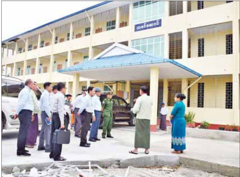
နယ်စပ်ရေးရာဝန်ကြီးဌာန ပြည်ထောင်စုဝန်ကြီး ဒုတိယဗိုလ်ချုပ်ကြီး ထွန်းထွန်းနောင် မုန်တိုင်းဒဏ်ကြောင့် ပျက်စီးဆုံးရှုံးမှုများ ရှိခဲ့သည့် ကျောက်ဖြူပညာရေးဒီဂရီကောလိပ်ရှိ သဇင်အိမ်ဆောင်အား ကြည့်ရှုစစ်ဆေးစဉ်။
