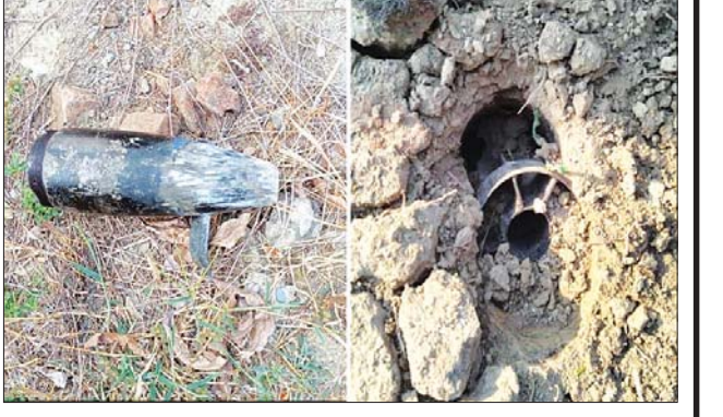
၂၃၀ ကေဗီ သာယာကုန်းပင်မဓာတ်အားခွဲရုံတွင် ကျရောက်ပေါက်ကွဲ သော ဗုံးများ မှတ်တမ်းဓာတ်ပုံ။
