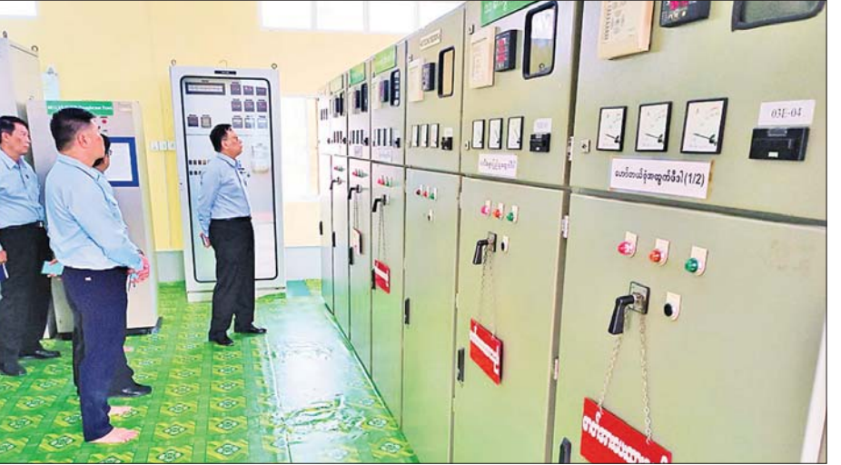
၆၆/၁၁ ကေဗွီ၊ ၂၀ အမ်ပီအေ၊ သံတွဲ (နန်းချောင်း) ဓာတ်အားခွဲရုံ ကို ကြည့်ရှုစစ်ဆေးပြီး ဓာတ်အား ခွဲရုံထိန်းသိမ်းပြုပြင်မှုကို ပုံမှန် စေရေး ကြိုတင်ပြင်ဆင်ဆောင် ဆောင်ရွက်ရန်နှင့် ဓာတ်အားခွဲရုံ ရွက်ရန် မှာကြားခဲ့သည်။ အတွင်း ရေစီးရေလာကောင်းမွန် သတင်းစဉ်
