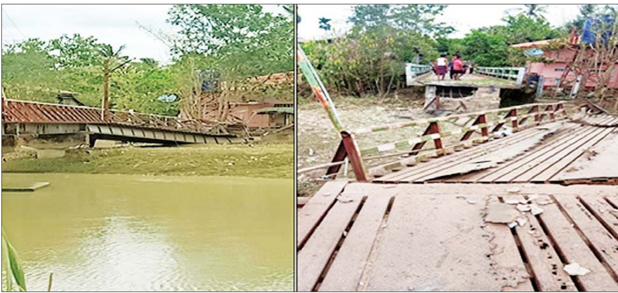
အကြမ်းဖက်သမားများ၏ မိုင်းထောင်ဖောက်ခွဲဖျက်ဆီးမှုကြောင့် ကျိုက်ထိုမြို့နယ် စစ်တောင်းကျေးရွာနှင့် ခဝါချောင်းကျေးရွာချင်းဆက်လမ်းပေါ်ရှိ သံပေါင်ဘေလီတံတား ပျက်စီးသွားမှုကို တွေ့ရစဉ်။
