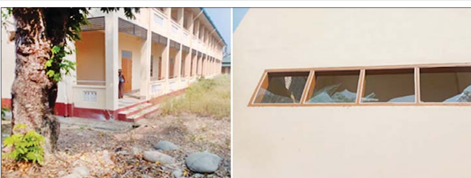
PDF အမည်ခံ အကြမ်းဖက်အဖွဲ့၏ မိုင်းထောင်ဖောက်ခွဲမှုကြောင့် ကလေးမြို့နယ် တောင်ဖီလာရပ်ကွက်ရှိ အမှတ်(၂)အခြေခံပညာအလယ်တန်းကျောင်းဝင်းအတွင်းရှိ ပင်မအဆောက်အအုံ၏ လေကာမှန်များ ပျက်စီးသွားမှုကို တွေ့ရစဉ်။
