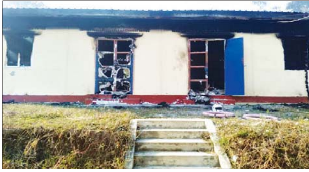
ကျေးလက်ဖွံ့ဖြိုးရေးရုံး ပျက်စီးမှု မှတ်တမ်းဓာတ်ပုံ။
