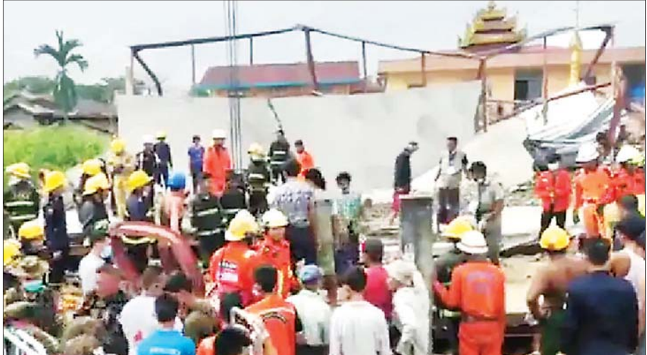
အဆောက်အအုံမှာ နှစ်ထပ်ခွဲ Steel Structure တည်ဆောက်ထားခြင်းဖြစ်ကြောင်း မြန်မာနိုင်ငံ သံမဏိရက်မပေါ် သံပြားခင်း၍ ကွန်ကရစ်လောင်း မီးသတ်တပ်ဖွဲ့ဌာနချုပ်မှ သိရသည်။ ကိုကြီးတင်
