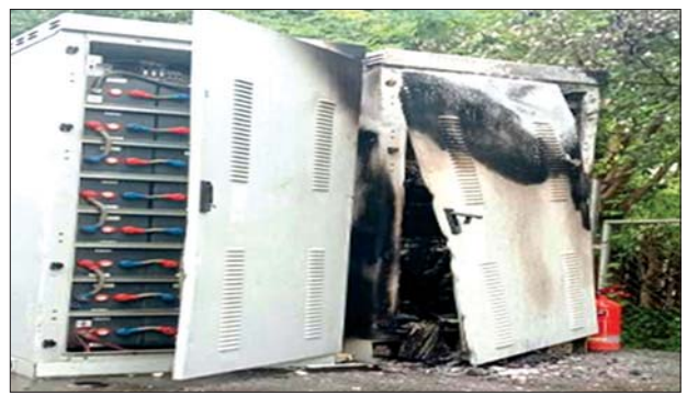
စဉ့်ကူးမြို့နယ် ကျည်တောက်ပေါက်ကျေးရွာ၌ စိုက်ထူထားသည့် Ooredoo ဆက်သွယ်ရေးတာဝါတိုင်၏ အထိုင်စက်ပုံးကို မီးရှို့ခံရသဖြင့် ပျက်စီးမှုကို တွေ့ရစဉ်။
