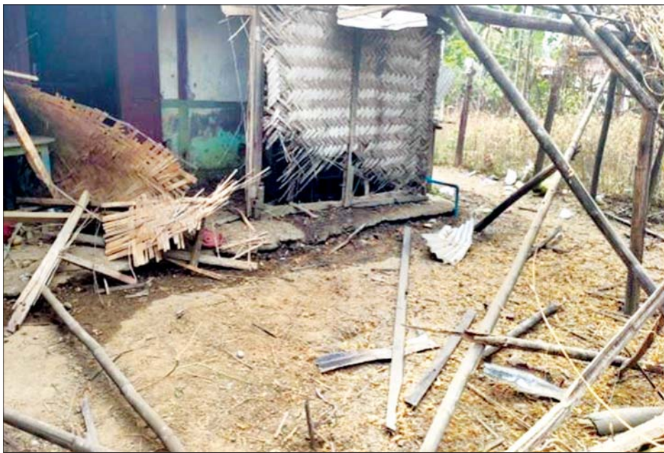
ရှေ့တိုက်ခွဲကျရောက်ပေါက်ကွဲမှုကြောင့် အောက်မော်မော်တော်ကားကျေးရွာရှိ နေအိမ်မီးဖိုချောင် ပျက်စီးမှုကိုတွေ့ရစဉ်။
