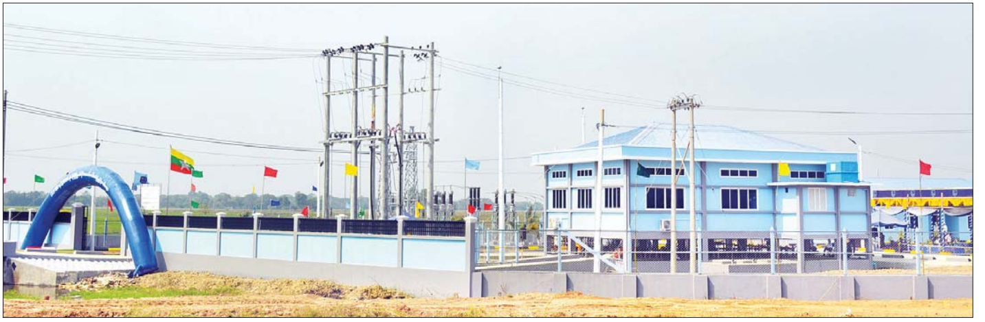
အသစ်ဖွင့်လှစ်လိုက်သော ရန်ကုန်တိုင်းဒေသကြီး တိုက်ကြီးမြို့နယ် အိုင်ကလောင် ဓာတ်အားခွဲရုံကို တွေ့ရစဉ်။
