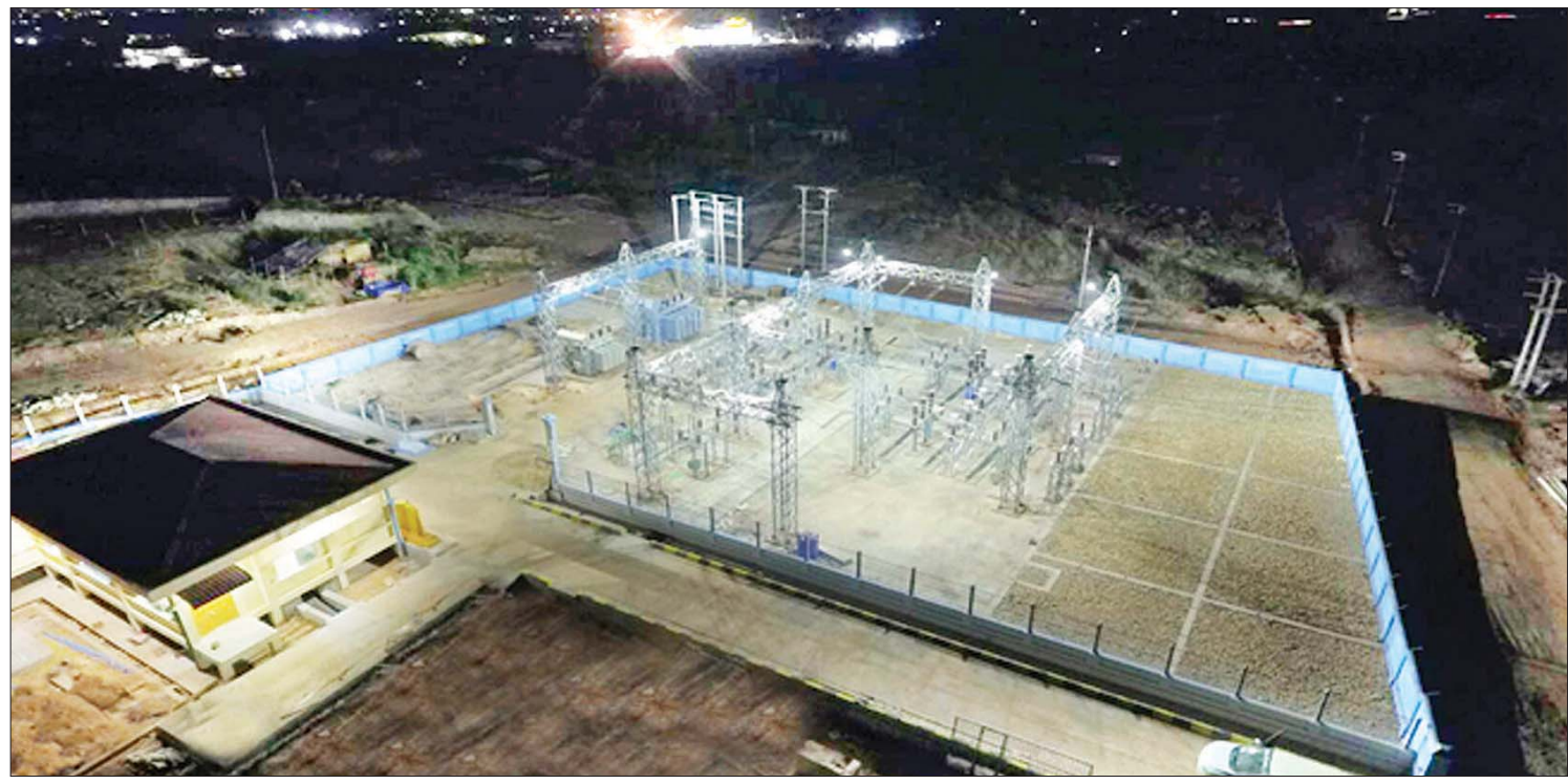
၆၆ ကေဗီ မြဝတီ-ကော့ကရိတ် ဓာတ်အားခွဲရုံကို တွေ့ရစဉ်။
