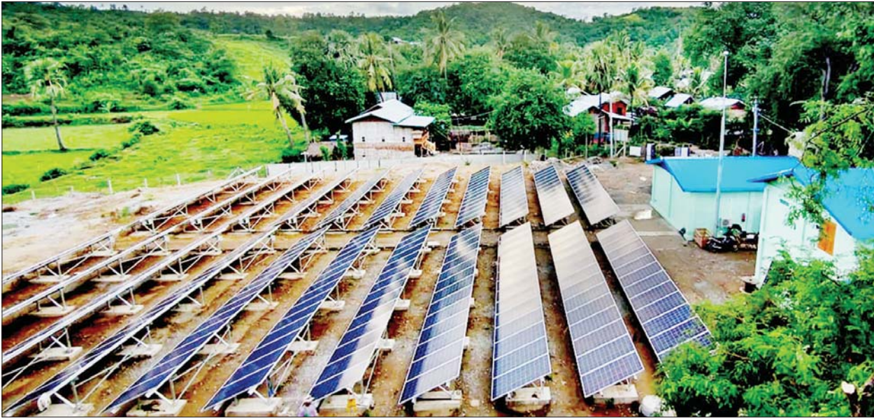
ပေါက်မြို့နယ်ရှိ ဆိုလာအသေးစားဓာတ်အားပေးစနစ် တည်ဆောက်ပြီးစီးမှုကို တွေ့ရစဉ်။
