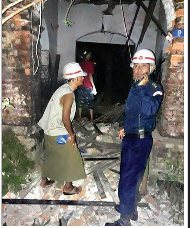
တိုက်ကြီးမြို့နယ်ရှိ ဘုန်းတော်ကြီးကျောင်းတစ်ကျောင်းမှ မျက်နှာကြက်များ ပြိုကျစဉ်
