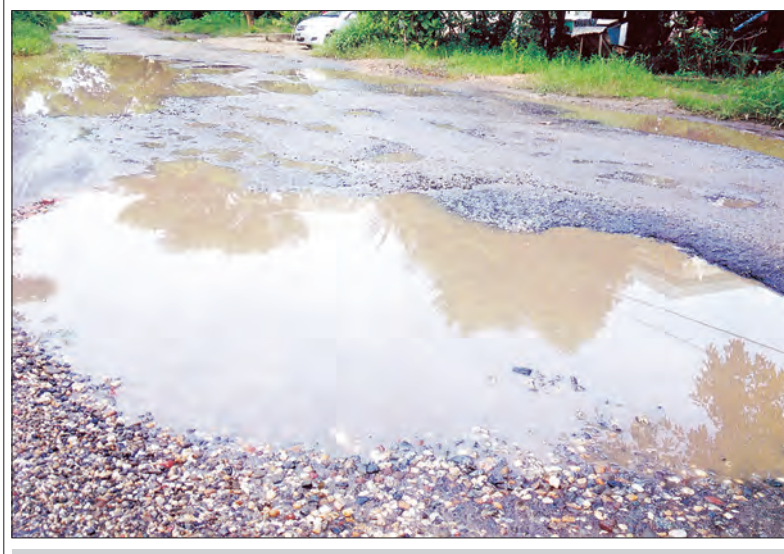
ရန်ကုန်တိုင်းဒေသကြီး ဒဂုံမြို့သစ်မြောက်ပိုင်း (၃၅) ရပ်ကွက်ရှိ သမိန်ပရမ်းလမ်းတွင် မိုးရွာသွန်းမှုများကြောင့် လမ်းများရေတိုက်စား၍ ချိုင့်ခွက်များဖြစ်ပေါ်နေမှုကြောင့် သွားလာရေးခက်ခဲနေသည်ကို အောက်တိုဘာလ နောက်ဆုံးပတ်က တွေ့ရစဉ်။ (အဆိုပါ လမ်းပျက်စီးမှုမှာ တောင်မြောက်အရှည်ပေ ၂၆၈၀ ရှိပြီး သက်ဆိုင်ရာမှ အမြန်ဆုံးပြုပြင်ပေးရန် ဒေသခံများက မျှော်လင့်လျက်ရှိကြောင်း သိရသည်။) စိန်ရွှေလှိုင်
