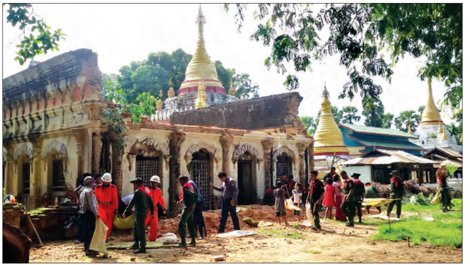
အာရုံခံအုတ်တိုက်အက်ကွဲမှုများ ဖြစ်ပေါ်ခြင်း အဆိုပါအုတ်တိုက်မှ ဇာတ်ကြီးဆယ်ဘွဲ့ရုပ်တုများ ပြုတ်ကျခြင်းများ လူ၊ တိရစ္ဆာန်တို့ ပျက်စီးဆုံးရှုံးမှုမရှိ ဖြစ်ပေါ်ခဲ့ပြီး အဆောက်အအုံ၊ လူနေ အိမ်ကြောင်း သိရသည်။ စိုးလင်းနိုင်
