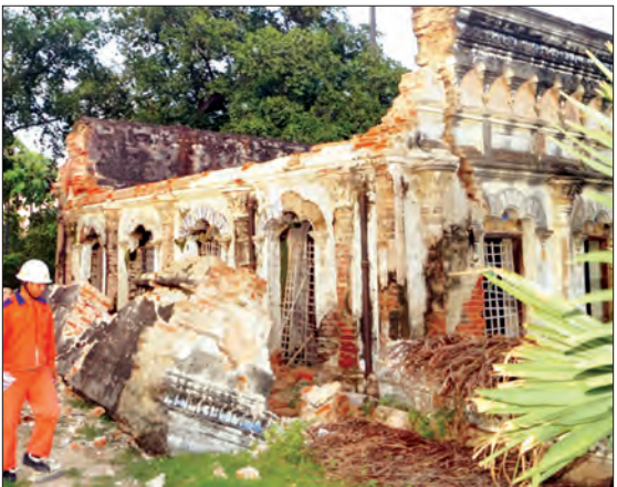
ဆိပ်ဖြူမြို့နယ်တွင် ဩဂုတ် ၂၄ ရက် ညနေ ၅ နာရီ ၅ မိနစ်ခန့်က လှုပ်ခတ်ခဲ့သည့် အင်အားပြင်းငလျင်ကြောင့် ဆန္ဒတော်ပြည့် အာရုံခံအုတ်တိုက်ရှေးဟောင်းအဆောက်အအုံ ပြိုကျမှုကိုတွေ့ရစဉ် (ပြန်/ဆက်)
