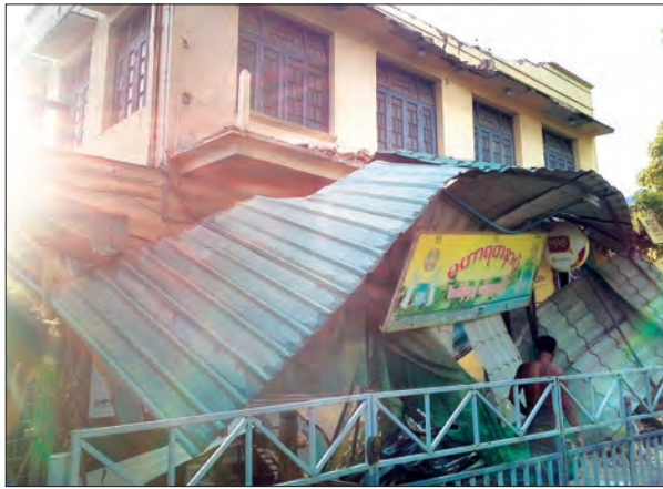
ချောက်မြို့တွင် အင်အားပြင်းငလျင်ကြောင့် လူနေအဆောက်အအုံအချို့ ပြိုကျပျက်စီးမှုကို တွေ့ရစဉ် ဝင်းအိမ့်နီ (ပြန်/ဆက်)
