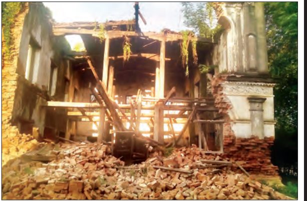
တောင်တွင်းကြီးမြို့နယ် မောင်းတိုင် (၂) ရပ်ကွက် အပိုင်း(၆)ရှိ မြောက်ပြင်အရှေ့ကျောင်းဝင်းအတွင်းရှိ ရဟန်းသံဃာမနေတော့သည့် နှစ်ထပ်တိုက်ကျောင်းဆောင်ဟောင်း ပြိုကျနေမှုကို တွေ့ရစဉ် (၀၈၅)
