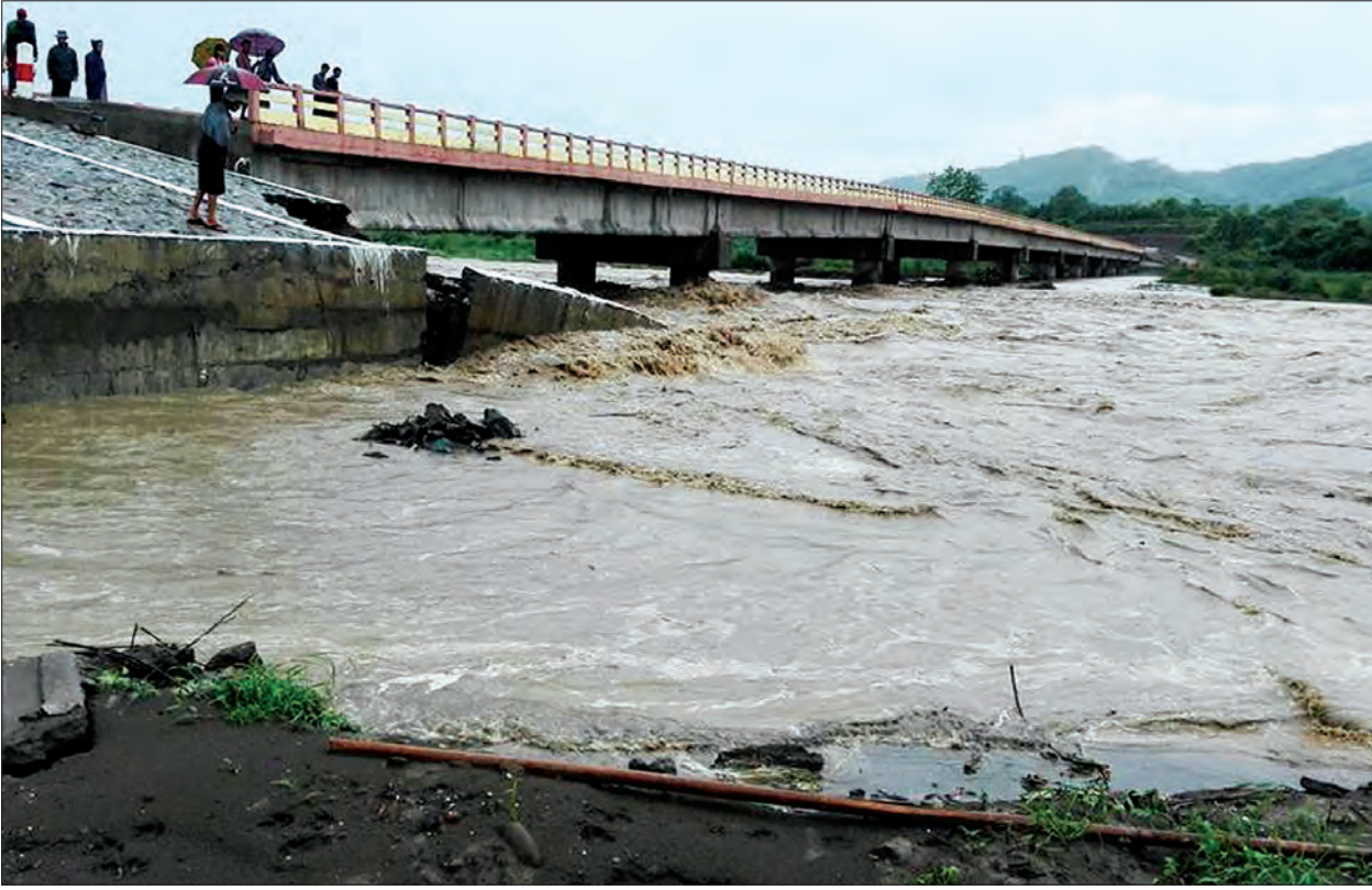
မင်းဘူးခရိုင် ငမဲမြို့နယ်နှင့် စေတုတ္တရာမြို့နယ်များတွင် ဇူလိုင် ၄ ရက်က မိုးအဆက်မပြတ်ရွာသွန်းခဲ့သဖြင့် စေတုတ္တရာ-ငမဲ ကားလမ်းပေါ်ရှိ ဆီမီးချောင်းတံတား ဘေးပေါင်များ ရေတိုက်စားပြီး ကမ်းကပ်ခုံပုံကျနေသည်ကို ဇူလိုင် ၅ ရက် ညနေပိုင်းက တွေ့ရစဉ်။ (ရေအရိန်ကြောင့် တံတားပျက်စီးပြီး လမ်းပန်းဆက်သွယ်ရေးပြတ်တောက်မည် ကို စိုးရိမ်စိတ်ဖြင့် ကြည့်ရှုနေသည့် ဒေသခံပြည်သူများကို တွေ့ရစဉ်။) သန်းနိုင်ဦး(ငမဲ)
