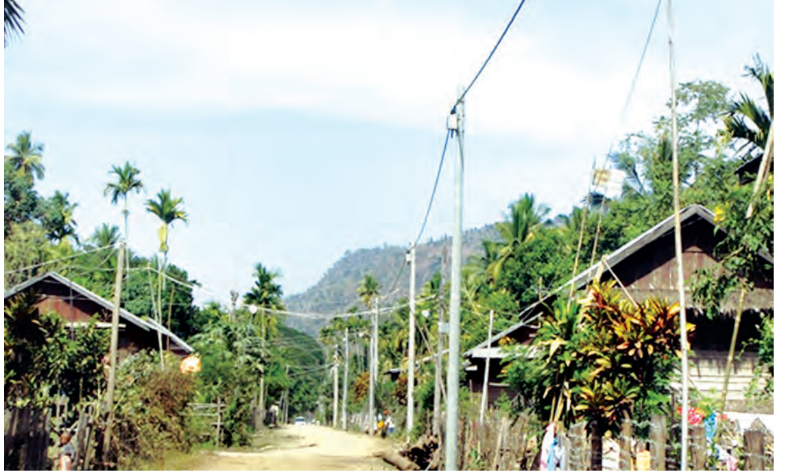
ရှားတောမြို့ပေါ်ရပ်ကွက်များ၌ လျှပ်စစ်ဓာတ်အားဖြန့်ဖြူးရေးအတွက် ဆောင်ရွက်ထားရှိမှုကို တွေ့ရစဉ်။
