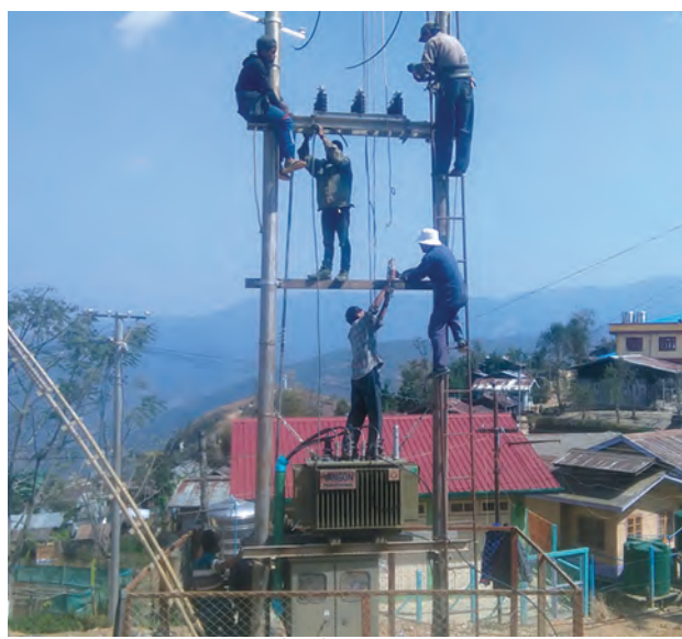
Link Connection များ တပ်ဆင်ခြင်း စသည့် လျှပ်စစ်အန္တရာယ်ကင်းရှင်းရေးလုပ်ငန်းများကိုပါ ဆောင်ရွက်လျက်ရှိကြောင်း သိရသည်။ လက်ရှိအချိန်တွင် တီးတိန်မြို့နှင့် ကျေးရွာသုံးရွာသို့ ဇာလွှဲရေးအား လျှပ်စစ်စက်ရုံမှ 200 KW ဓာတ်အားပေးစက်နှစ်လုံးနှင့် 300 KVA ဒီဇယ် ဓာတ်အားပေးစက်များဖြင့် တစ်ရက်လျှင် ၁၆ နာရီခန့် ဓာတ်အားပေးလျက်ရှိရာ ထရန်စဖော်မာ သစ်များ ပြီးစီးပါက ဓာတ်အားပျောက်ဆုံးမှုလျော့နည်းပြီး ပြည်သူများ လျှပ်စစ်ဓာတ်အားအသုံးပြုမှုပို၍ အဆင်ပြေစေမည်ဖြစ်ကြောင်း သိရသည်။ နေဇော်(ရင်းရိုးမ)
