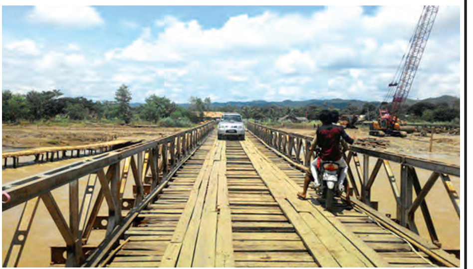
မကွေးတိုင်းဒေသကြီး ငမဲ-စေတုတ္ထရာလမ်းပေါ်ရှိ မန်းချောင်းတံတား ယာယီဘောလီတံတားတည်ဆောက်ပြီး၍ ယာဉ်များ ဖြတ်သန်းနေသည်ကို တွေ့ရစဉ်။ (ဆောက်လုပ်ရေး)
