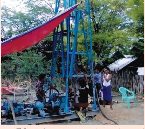
ရေစိုက်မြို့နယ်တွင် သောက်သုံးရေမလုံစွာရရှိရေးအတွက် ကျေးလက်ဒေသဖွံ့ဖြိုးရေးဦးစီးဌာနရန်ပုံငွေဖြင့် ဇွန် ၂၀ ရက်က စက်ရေတွင်းတူးဖော်ပေးနေစဉ်။(ရေစိုက်မြို့နယ်အတွင်း ကျေးရွာ ၁၂ ရွာ၌ စက်ရေတွင်း ၁၀ တွင်းနှင့် တွင်းတိမ် နှစ်တွင်းတူးဖော်သွားမည်ဟု သိရသည်။) ဗေထွန်းမော်(ရေစိုက်)
