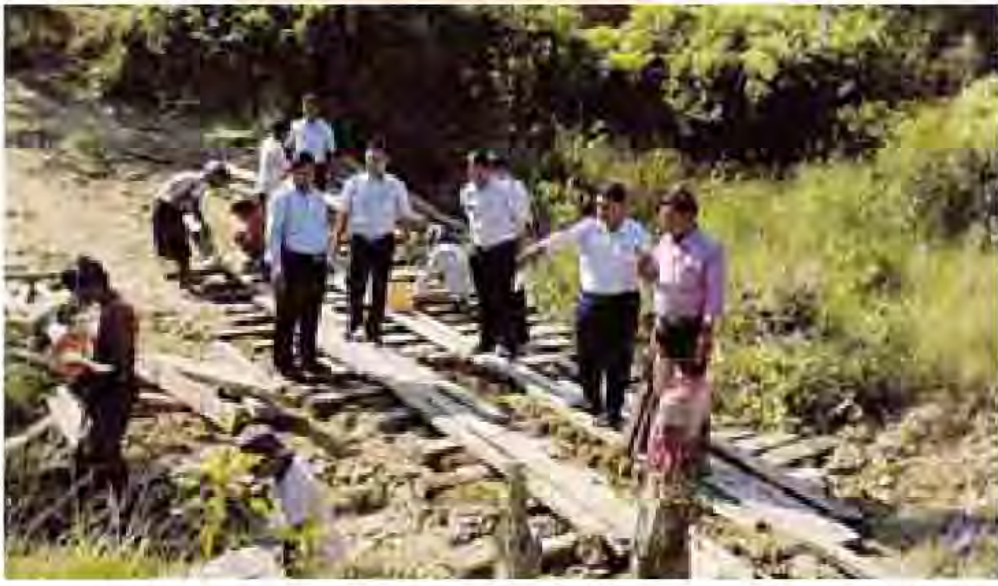
မောင်တောမြို့နယ် ကျေးလက်ဒေသဖွံ့ဖြိုးတိုးတက်ရေးဦးစီးဌာန၏ ၂၀၁၄-၂၀၁၅ ဘဏ္ဍာရေးနှစ် ခွင့်ပြုငွေကျပ် ၂၅ သန်းဖြင့် တည်ဆောက်နေသော ငွေတောင်- သာယာကုန်း တံတားတည်ဆောက်နေမှုများကို မောင်တောခရိုင် ကျေးလက်ဒေသဖွံ့ဖြိုးတိုးတက်ရေးဦးစီးဌာနမှူး ဦးစောဝေနှင့်အဖွဲ့ ဒီဇင်ဘာ ၂၄ ရက်က သွားရောက်စစ်ဆေးစဉ်။ (အဆိုပါ တံတားသည် အလျားပေ ၅၀၊ အနံ ၁၀ ပေ၊ အမြင့် ၁၄ ပေရှိပြီး ငွေတောင်ရွာနှင့် သာယာကုန်းရွာကြားတွင် တည်ဆောက်ထားရာ ကျေးလက် နေပြည်သူများအတွက် ရာသီမရွေး အသုံးပြုနိုင်မည့် တံတားတစ်စင်းဖြစ်ကြောင်း သိရသည်။)
