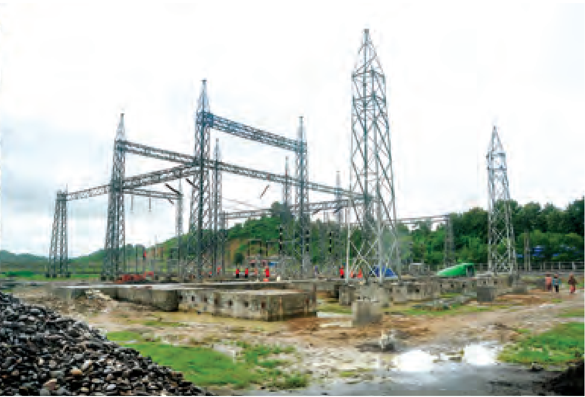
ဒုတိယသမ္မတ ဒေါက်တာစိုင်းမောင်ခမ်း ပုဏ္ဏားကျွန်းမြို့လှုပ်စစ်ဓာတ်အားခွဲရုံကို ကြည့်ရှုစစ်ဆေးစဉ်။ (သတင်းစဉ်)
