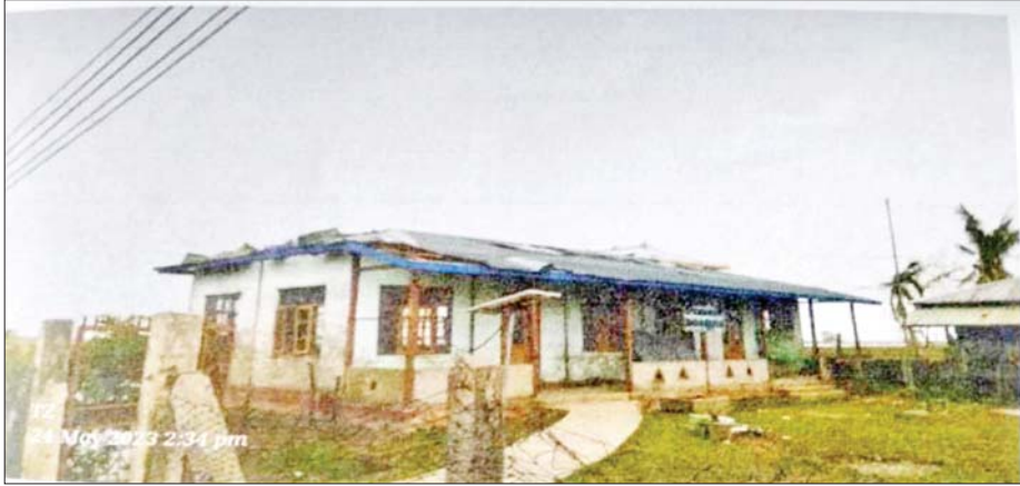
ရခိုင်ပြည်နယ် မင်းပြားမြို့နယ်ရှိ မိခင်မုန့်တိုင်းဒဏ်ကြောင့် ပျက်စီးခဲ့သည့် အမက ထောင့်ချောင်းကြီး RCC တစ်ထပ်ကျောင်းဆောင်ကို တွေ့ရစဉ်။
