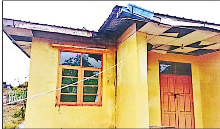
ရခိုင်ပြည်နယ် မင်းပြားမြို့နယ်၌ မိုခါမုန်တိုင်းဒဏ်ကြောင့် ပျက်စီးသွားသည့် အထက်/ငှက် ကျေးလက်ကျန်းမာရေးဌာနခွဲ အဆောက်အအုံကို တွေ့ရစဉ်။
