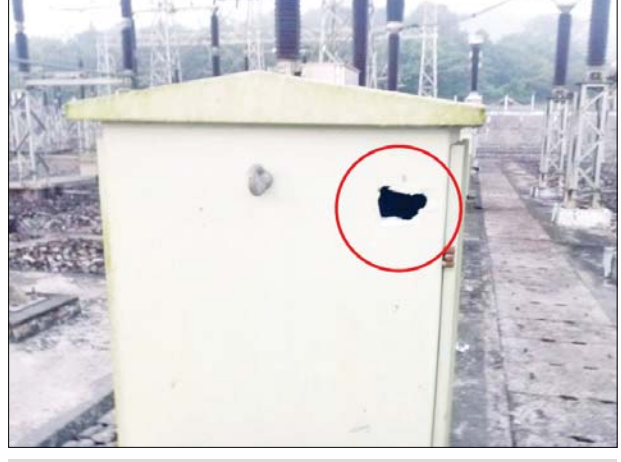
50 MVA Generator Circuit Breaker ပျက်စီးမှု မှတ်တမ်းဓာတ်ပုံ။
