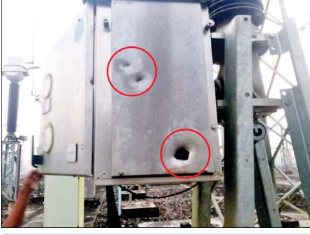
50 MVA Generator Circuit Breaker ပျက်စီးမှု မှတ်တမ်းဓာတ်ပုံ။
