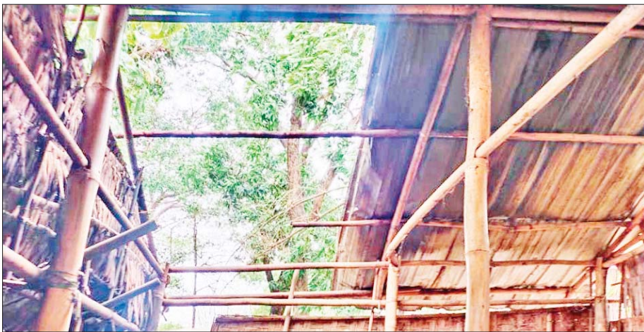
ဧရာဝတီတိုင်းဒေသကြီး ကျောင်းကုန်းမြို့နယ်အတွင်းရှိ ကျေးရွာအချို့၌ လေပြင်းတိုက်ခတ်မှုကြောင့် အိမ်များပျက်စီးဆုံးရှုံးမှုကို တွေ့ရစဉ်။ မြို့နယ်(ပြန်/ဆက်)
