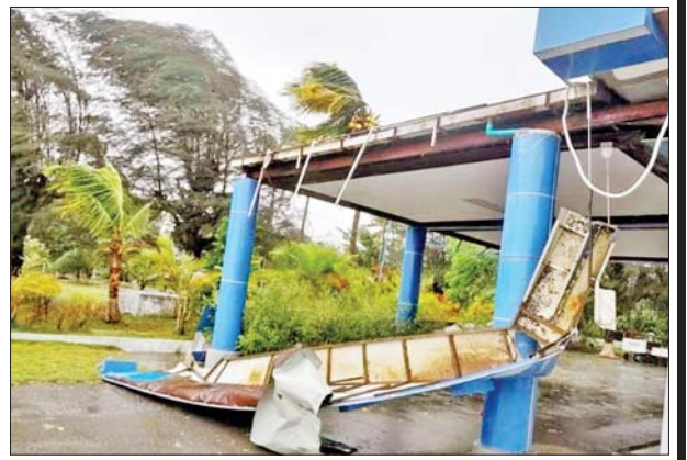
သံတွဲမြို့နယ်အတွင်းရှိ ငပလီလေယာဉ်ကွင်း VIP အဆောင်ဆင်ဝင်အမိုးလန် ပျက်စီးမှုကို တွေ့ရစဉ်။ ဓာတ်ပုံ-ခရိုင်(ပြန်/ဆက်)
