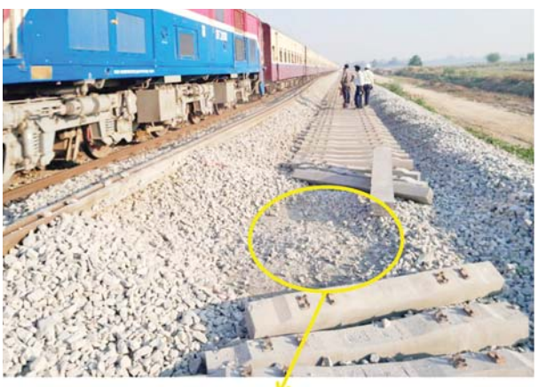
မိုင်းပေါက်ကွဲ၍ ကွန်ကရစ်ဇလီဖားတုံးသစ်များ ထိခိုက်ပျက်စီးမှု။
