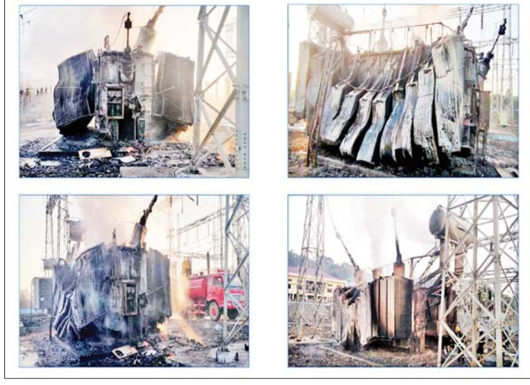
၂၃၀ ကေဗီ မြဝတီပင်မဓာတ်အားခွဲရုံ၏ 230 kV, 20 MVA Shunt Reactor ပျက်စီးမှုအခြေအနေ မှတ်တမ်းဓာတ်ပုံ။
