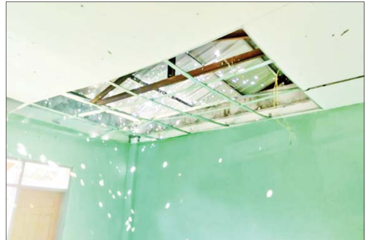
ကော့ကရိတ်မြို့နယ်ရှိ အထက်(ချောင်းတောင်)အား Drone ဖြင့် ဗုံးခွဲတိုက်ခိုက် မှုကြောင့် ပျက်စီးဆုံးရှုံးမှုကို တွေ့ရစဉ်။
