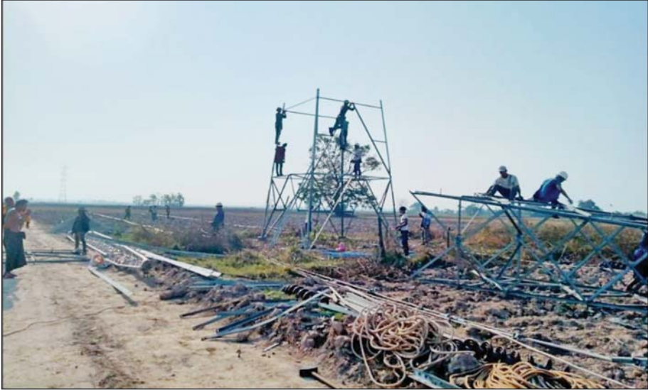
၁၃၂ ကေဗီ ဘီလူးချောင်း(၂)-တီကျစ် ဓာတ်အားလိုင်း တာဝါတိုင်အမှတ် (၁၀၅) ပြန်လည်ပြုပြင်နေမှု မှတ်တမ်းဓာတ်ပုံ။
