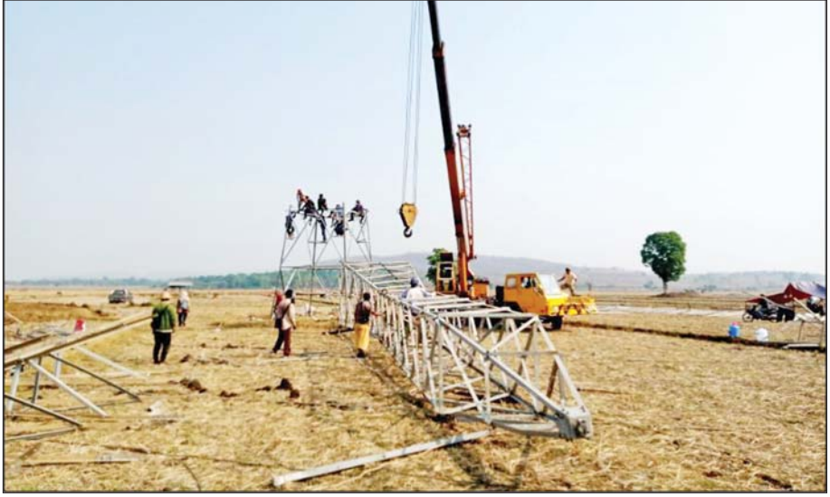
၁၃၂ ကေဗီ ဘီလူးချောင်း(၂)-တီကျစ် ဓာတ်အားလိုင်း တာဝါတိုင်အမှတ် (၁၀၁) ပြန်လည်ပြုပြင်နေမှု မှတ်တမ်းဓာတ်ပုံ။
