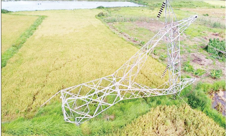
၁၃၂ ကေဗီ ရွှေစာရ်-တံခွန်တိုင် ဓာတ်အားလိုင်းမှ ပြုလဲပျက်စီးနေသည့် တာဝါတိုင် အမှတ်(၄၄)၏ မှတ်တမ်းဓာတ်ပုံ။
