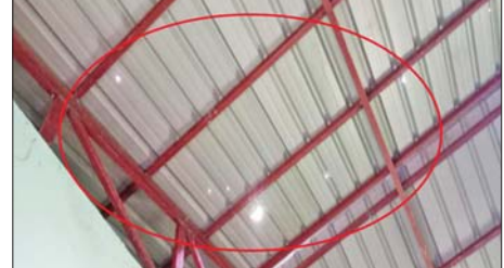
Drop ဗုံးတစ်လုံး ကျရောက်သဖြင့် ကျောင်းအဆောက်အအုံ ခေါင်မိုး တစ်ပေ ပတ်လည် ပေါက်ပြဲမှု မှတ်တမ်းဓာတ်ပုံ။
