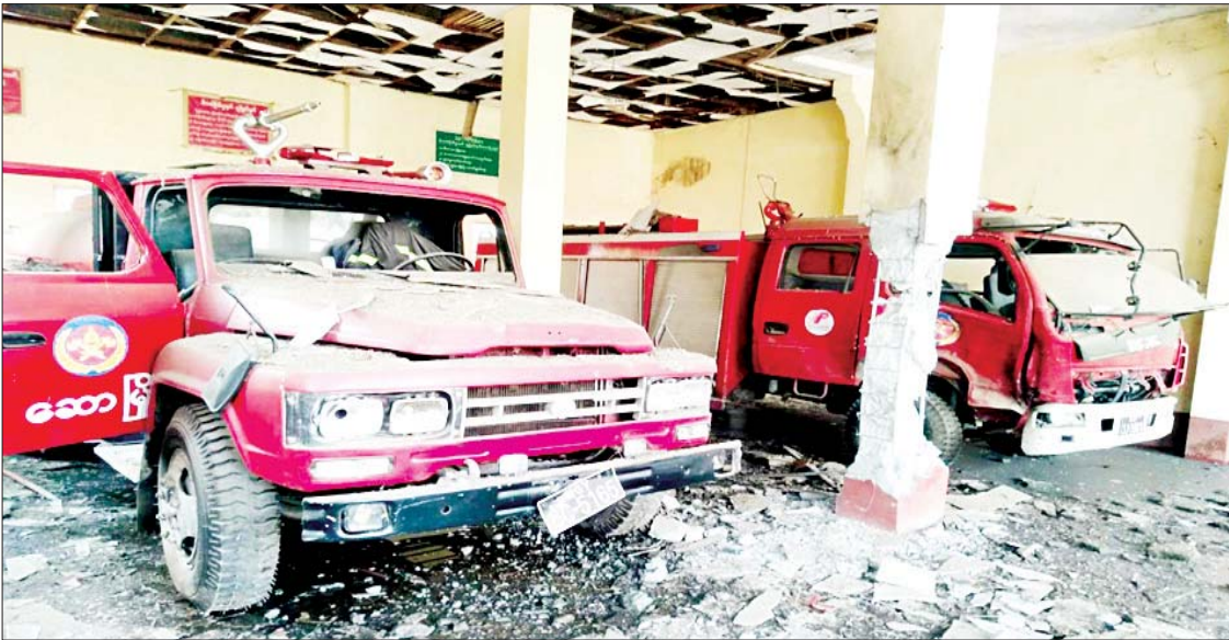
ဆောမြို့ရှိ မီးသတ်ဦးစီးဌာနရုံးအဆောက်အအုံနှင့် မီးသတ်ယာဉ်ပျက်စီးမှု မှတ်တမ်းဓာတ်ပုံ။
