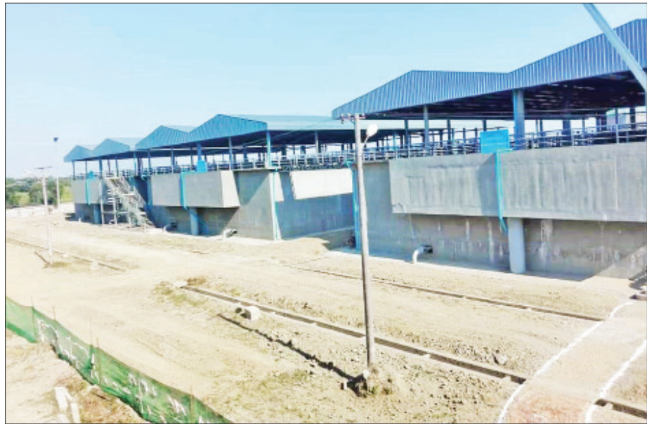
ဒဂုံမြို့သစ်အရှေ့ပိုင်းမြို့နယ်ရှိ လဂွန်းပြင် ရေရရှိရေးစီမံကိန်း ရေစစ်ကန်ကို တွေ့ရစဉ်။
