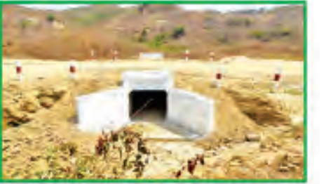
ဥဒေါင်း-ညောင်ချောင်းတောင်ကျော်လမ်း Box Culvert တည်ဆောက်ခြင်းလုပ်ငန်းဆောင်ရွက်နေပုံ
