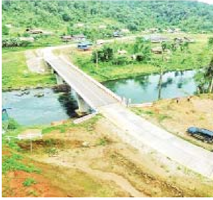
၂၀၁၉-၂၀၂၀ ဘဏ္ဍာနှစ် မချမ်းဘော-ဖရူခ-ရပ်ဘော-နောင်မွန်လမ်းပေါ်ရှိ တံတားအမှတ်(၃/၂၂) ထာခတ်တား ပေ ၂၀၀ တည်ဆောက်ပြီးစီးမှုကို တွေ့ရစဉ်။
