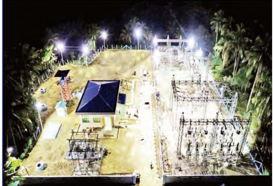
၆၆ ကေဗီ ငရုတ်ကောင်း-ငရုတ်ကောင်းတောင် ဓာတ်အားခွဲရုံ။
