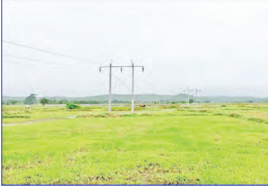
၆၆ ကေဗီ ငရုတ်ကောင်း-ငရုတ်ကောင်းတောင် ဓာတ်အားလိုင်းသွယ်တန်းထားမှုကို တွေ့ရစဉ်။
