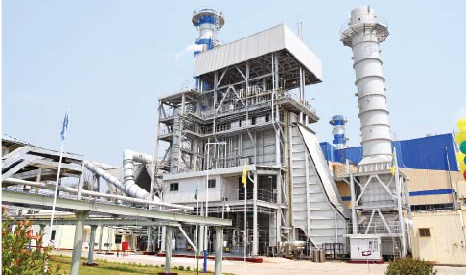
သထုံမြို့ရှိ ၁၁၈ ဒသမ ၉ မဂ္ဂါဝပ် သဘာဝဓာတ်ငွေ့သုံး ဓာတ်အားပေးစက်ရုံကို တွေ့ရစဉ်။
