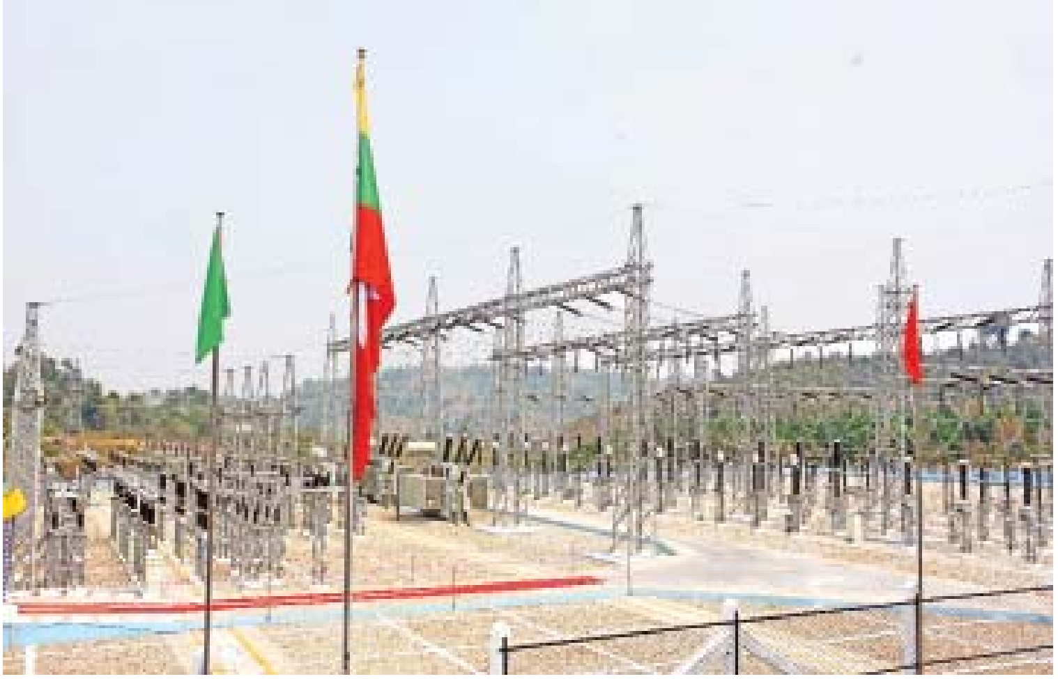
မြဝတီပင်မဓာတ်အားခွဲရုံကို တွေ့ရစဉ်။
