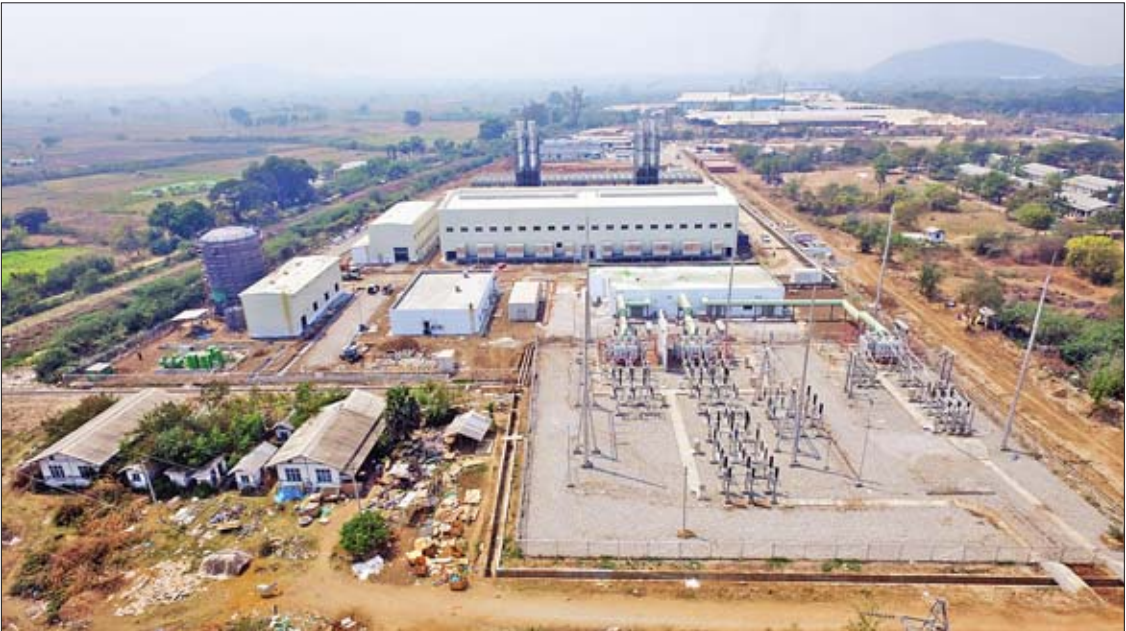
ကျောက်ဆည်မြို့နယ်ရှိ သဘာဝဓာတ်ငွေ့သုံး ဓာတ်အားပေးစက်ရုံကို တွေ့ရစဉ်။
