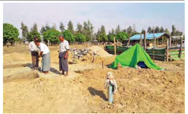
ကနီမြို့နယ်အတွင်း နေရာသီရေရွာပါးပြတ်လပ်နိုင်သော ဗုံရွာ-ယာကြီး- ကလေးဝလမ်း (၃၂/၀)ခိုင်(အင်တိုင်းတော) သစ်တောကုန်းတောင်သူများအား ၂၀၁၆- ၂၀၁၇ ဘဏ္ဍာနှစ်တွင် ကျေးလက်ဒေသဖွံ့ဖြိုးတိုးတက်ရေးဦးစီးဌာန ရန်ပုံငွေဖြင့် Tech United Power ကုမ္ပဏီက တာဝန်ယူဆောင်ရွက်သော စက်ရေတွင်းတူးဖော်ခြင်းကို ကနီမြို့နယ် ကျေးလက်ဒေသဖွံ့ဖြိုးတိုးတက်ရေး ဦးစီးဌာန မြို့နယ်ဦးစီးမှူး ဦးကျော်ဆိုင် မတ် ၁၆ ရက်က ကွင်းဆင်းစစ်ဆေး စဉ်။ (ကနီကျေးလက်)
