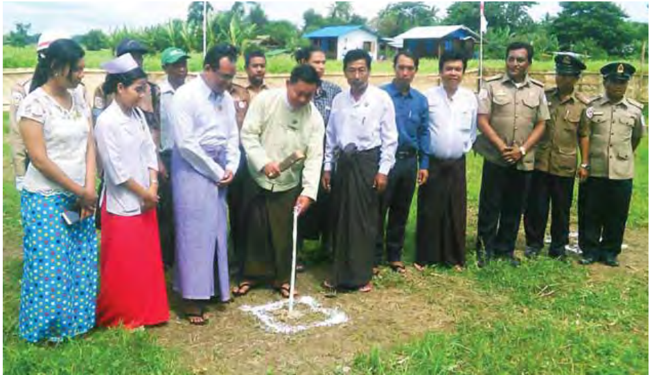
ခြင်းဖြစ်ပြီး ကျန်းမာရေးဌာနခွဲအဆောက်အအုံမှာ ပေ(၆၀ x ၈၀) အကျယ် မြေစိုက်တစ်ထပ် RCသွပ်မိုးအဆောက်အအုံဖြစ်သည်။
